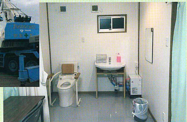
感染者との動線を分けるためのコンテナハウスです。
